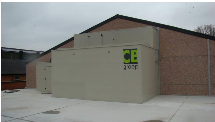
Figuur 1 : Zicht op de luchtwasser bij ██████████
